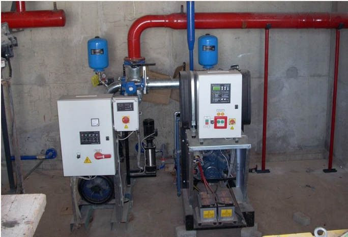
Impianto tecnico antincendio: pompe e distribuzione.
