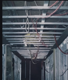
Distribuzioni e impianti sopra i corridoi.
