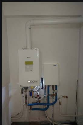
Caldaia e circuito idronico.
