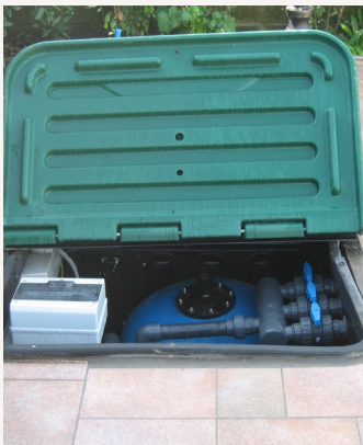
Locale tecnico interrato.
