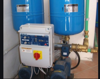
Gruppo autoclave e pressurizzazione.
