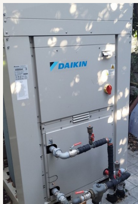
Chiller Daikin / generazione frigorifera.
