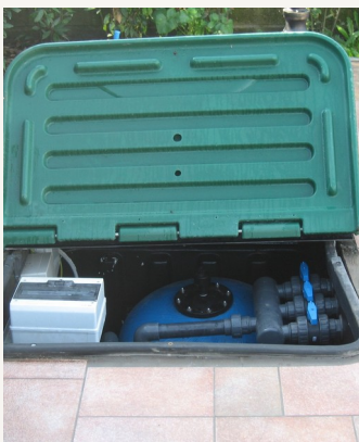
Sala técnica enterrada.
