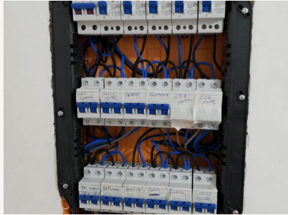
Cuadro eléctrico en fase de ejecución.
