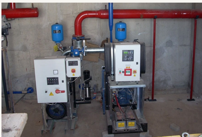
Instalación técnica contra incendios: bombas y distribución.
