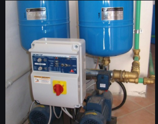
Grupo de presión y presurización.
