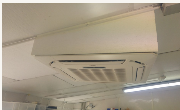
Climatización tipo cassette • laboratorio en Madrid.
