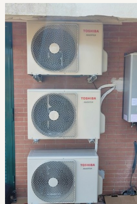
Unidades exteriores / distribución.
