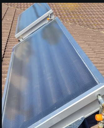
Solar térmica · integración.
