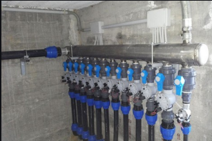
Distribución de agua y colectores.
