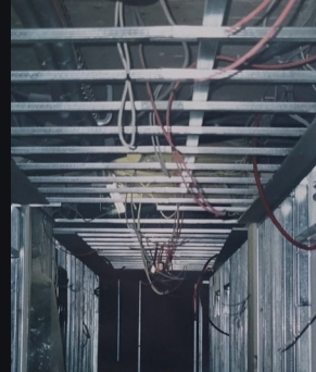
Distribuciones e instalaciones sobre los pasillos.
